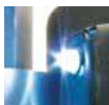
Iluminación interior mediante LEDs de bajo consumo
