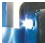
Iluminación interior mediante LEDs de bajo consumo.
