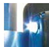
Iluminación interior mediante LEDs de bajo consumo
