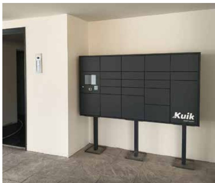
Instalación en exterior cubierto
