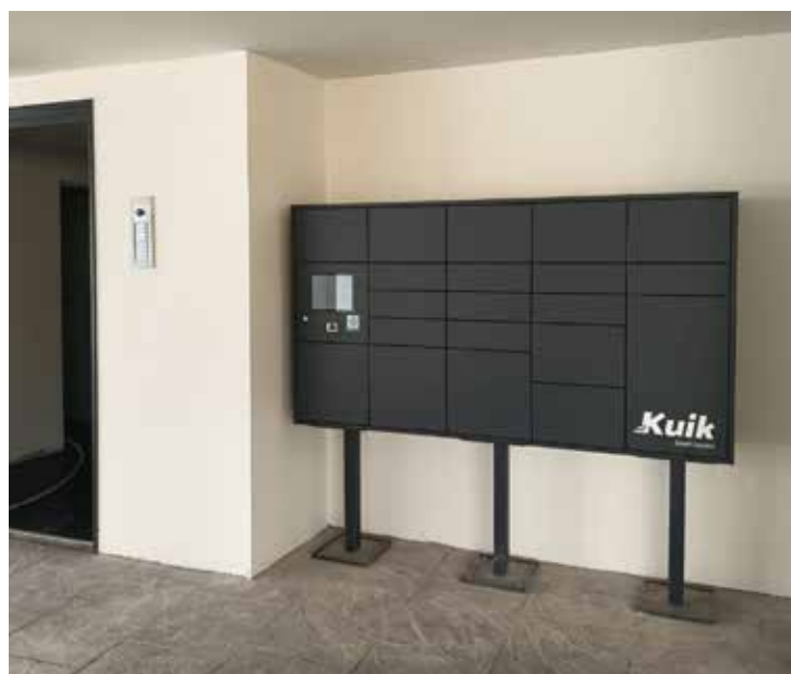
Instalación en exterior cubierto
